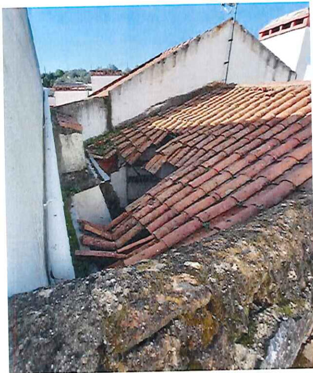
cobertura parcialmente arruinada
