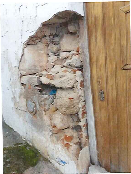
desagregação da ombreira da porta
